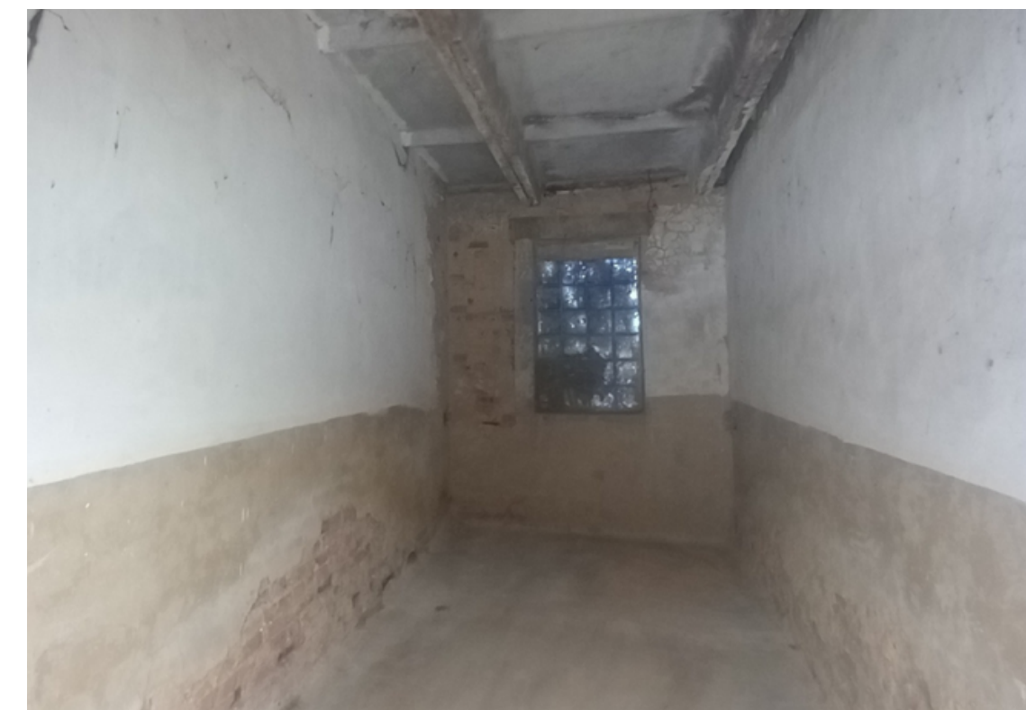
Стан приміщення пожежного депо до ремонту
