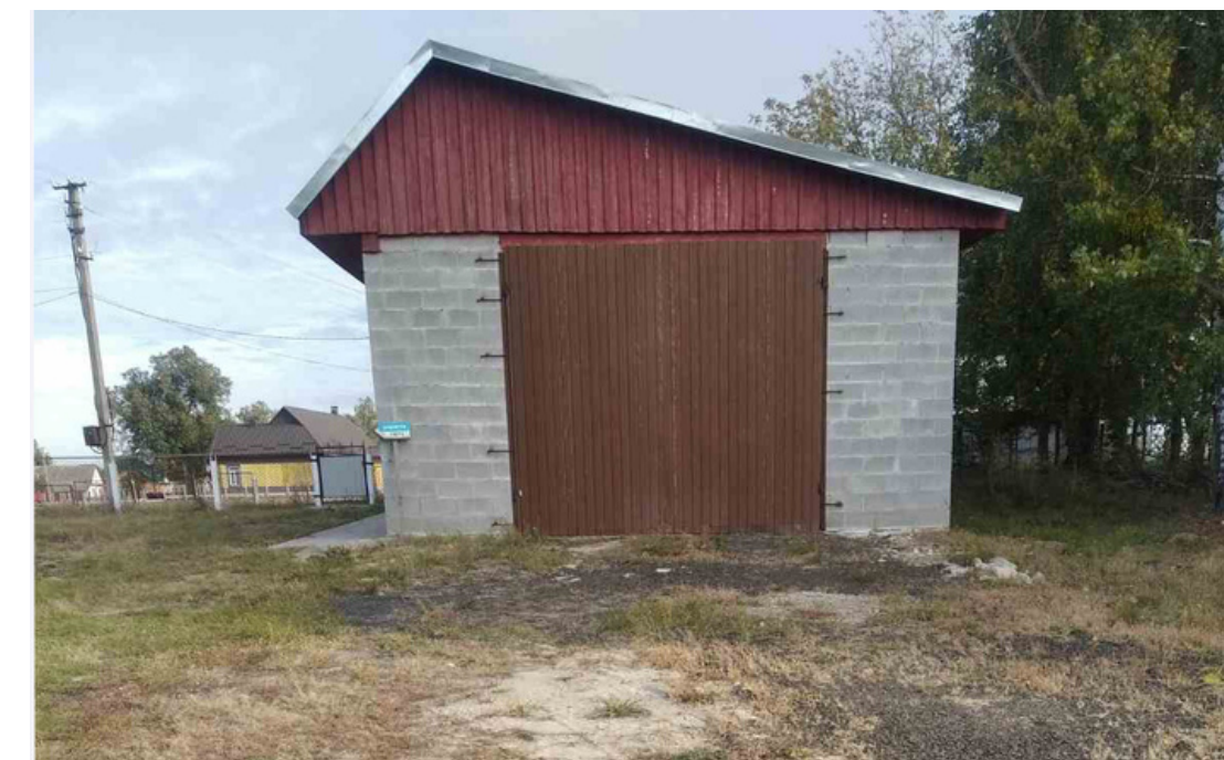
Пожежне депо с. Кухче до ремонту
